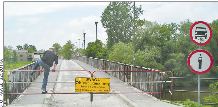
Część oświęcimian lekceważy zakaz przejścia przez kładkę.
