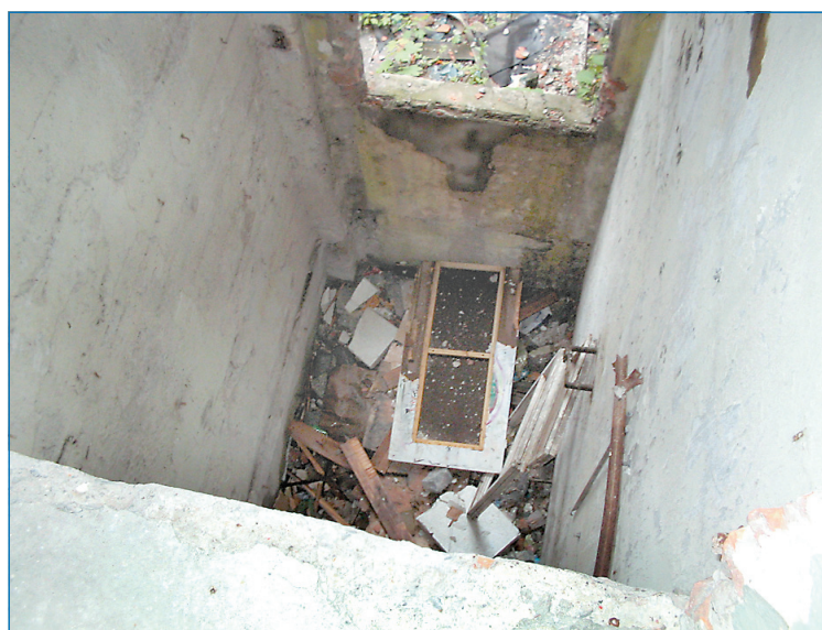
Niezabezpieczony szyb po fabrycznej windzie.
