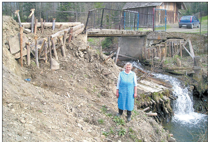
Helena Kaprak próbuje sama ratować uszkodzoną drogę.
