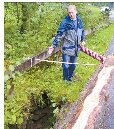
- Na naprawę tej wyrwy ludzie czekają już od ponad dwóch miesięcy! - żali się gminny radny Andrzej Krempel.
