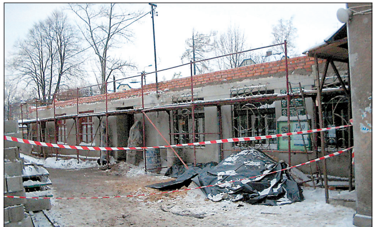
Budynek dawnego Domu Polskiego będzie miał nowy dach.
