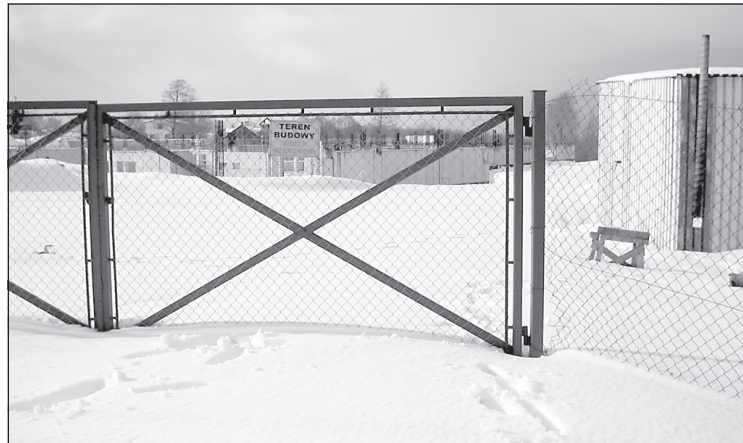
W Bielsku-Białej budowa aquaparku jak na razie zakończyła się na fundamentach. Po wylaniu betonu inwestycję wstrzymano.
