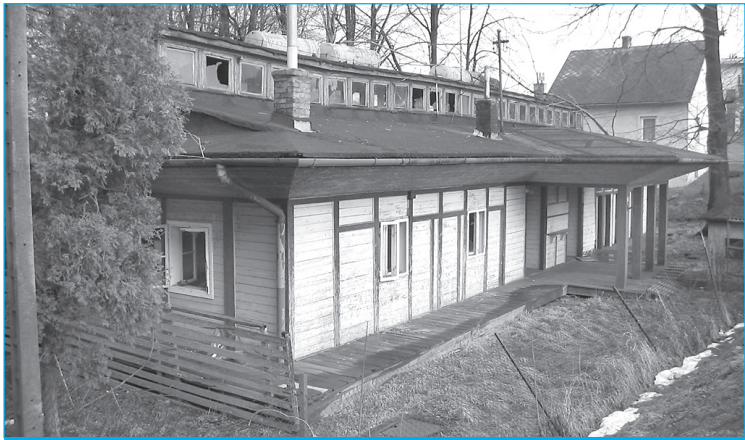
Zniszczone zaplecze jaworzańskiego basenu wkrótce ma zostać rozebrane.
