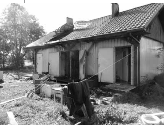
Po pożarze budynek socjalny przy ul. Dolny Bór nie nadaje się do zamieszkania. Fot. Ryszard Stelmaszczyk
