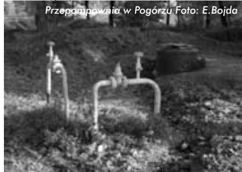
Przepompownia w Pogórze Foto: E.Bojda
