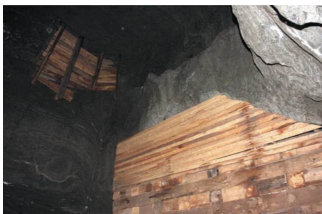
Rys. 3. Ocios wschodni, komora z półką solną podpartą obudową drewnianą, fot.: A. Maj [11]
