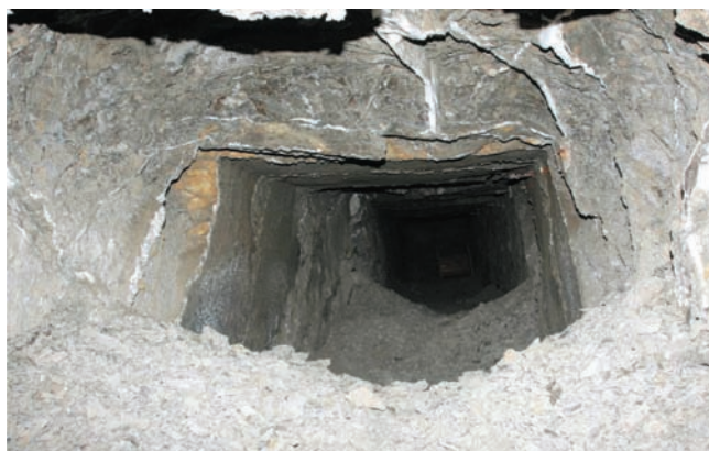
Rys. 4. Destrukcja ociosu północnego komory i chodnika w kierunku północnym, fot.: A. Maj [11]
