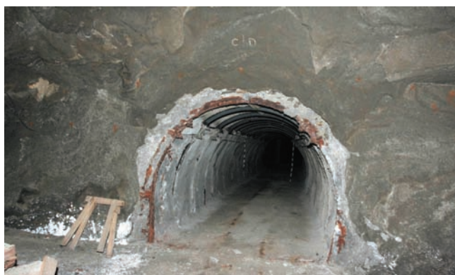
Rys. 2. Wlot do komory Ferdynand d'Este. Widoczna korozja łuków ŁP i wypełnienie obudowy chodnika betonem natryskowym, fot.: A. Maj [11]
