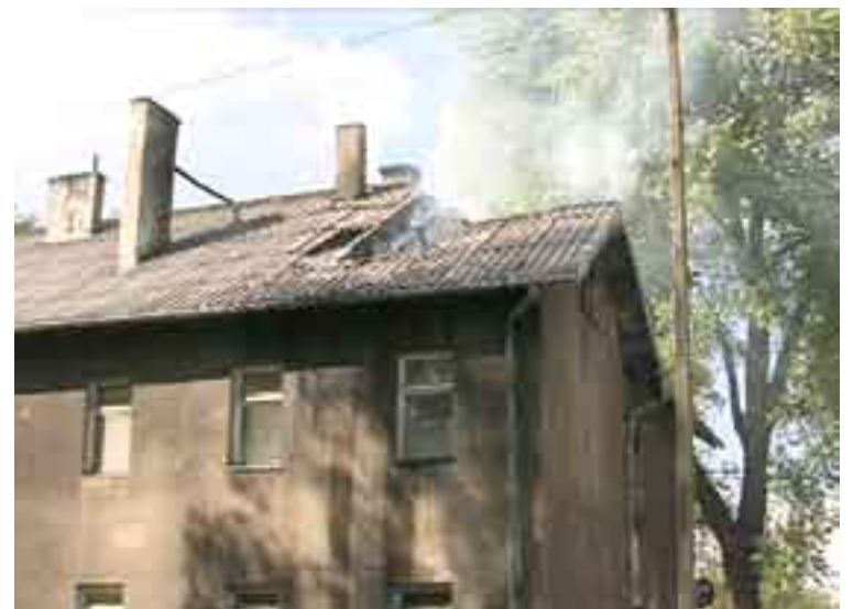
W pożarze zniszczeniu uległo 30 m² pokrycia dachu
