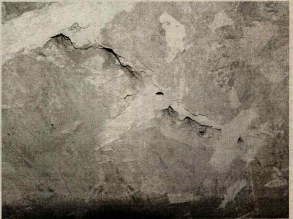
Oprócz ciekącego dachu w budynku pękają jeszcze ściany
