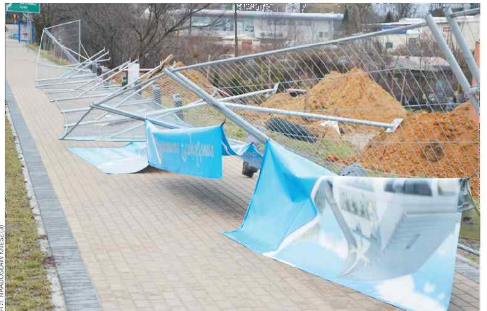
Na szczęście nikt nie przechodził chodnikiem na Budowlanych, kiedy wiatr przewrócił metalowe ogrodzenie
