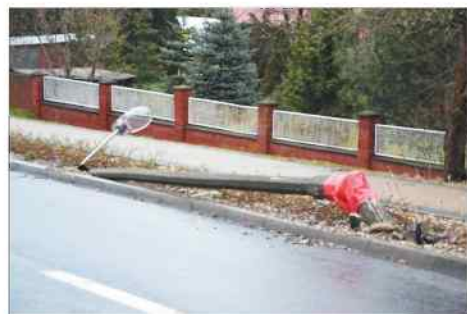
Złamany maszt latarni ulicznej mógł pozbawić życia przechodnia
