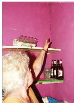
W domu Bronisławy Wojtczak znajdziemy spore pęknięcia
