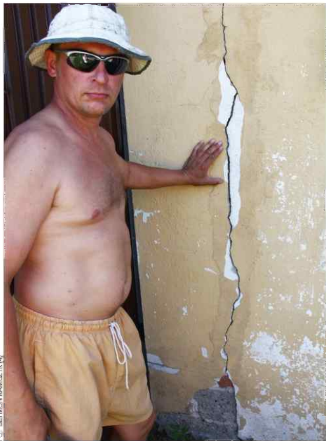
Andrzej Salamon wskazuje potężne szczeliny w ścianie
