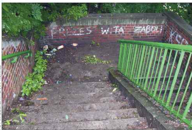
Schody prowadzące na stację PKP Czerwionka Dębieńsko to jeden wielki śmietnik i siedlisko smrodu
