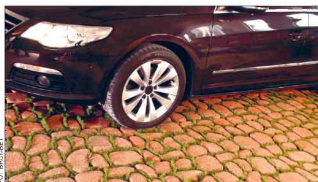
Ekologiczne betonowe elementy stosowane są jako nawierzchnie miejsc parkingowych. Tu w postaci kamiennych otoczek.
