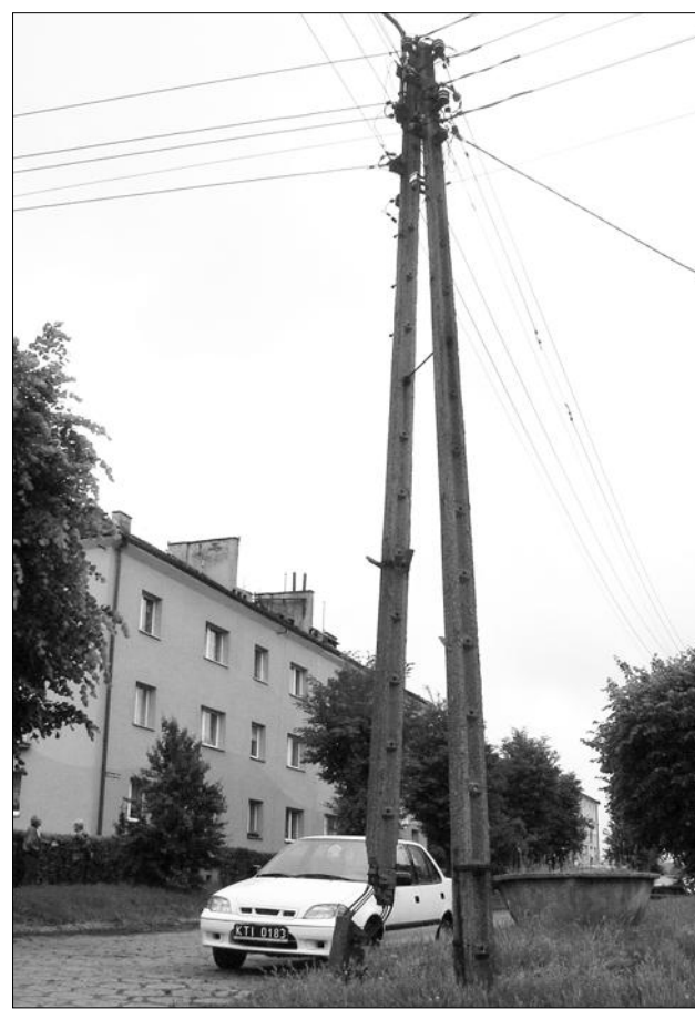
Słup jest w opłakanym stanie
