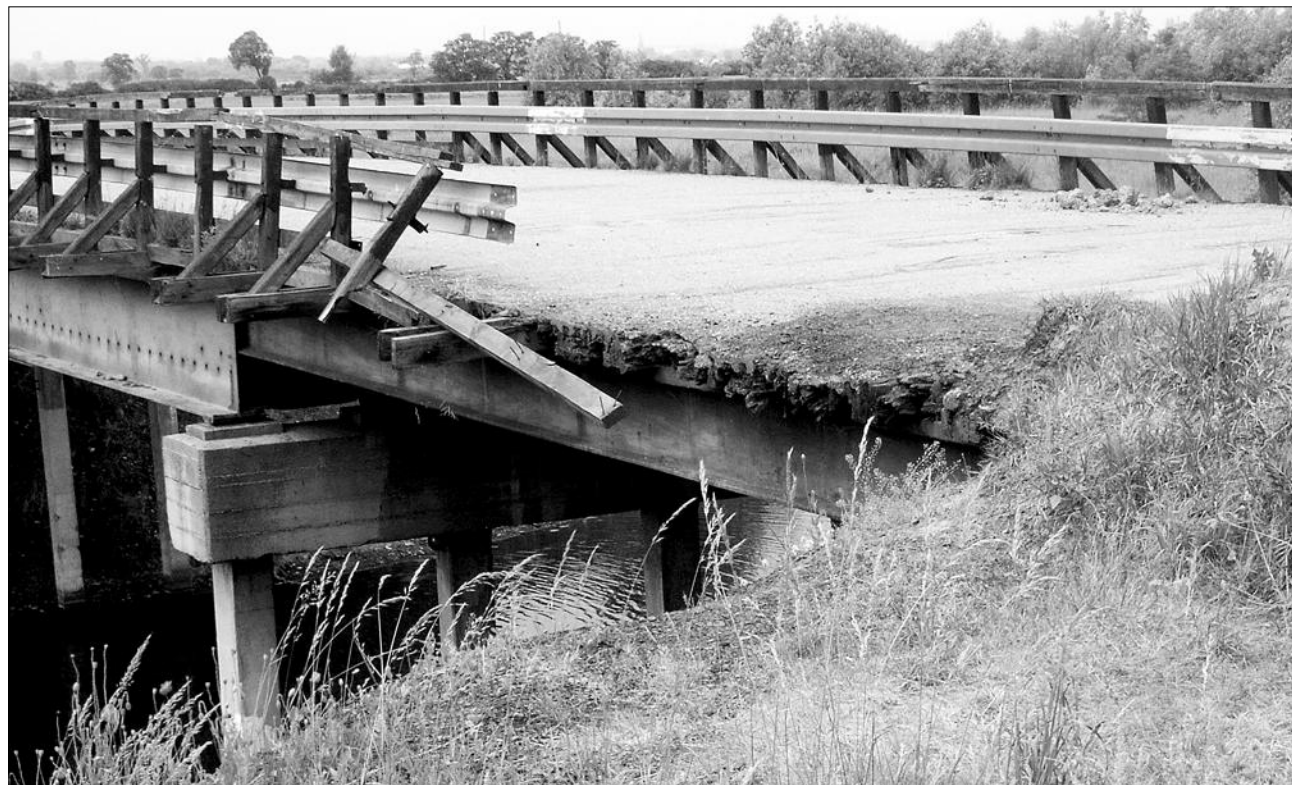
Stan mostu zagraża bezpieczeństwu użytkowników
