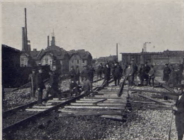
Gleisanschlußanlage Dtsch. Blei-Scharleygrube
