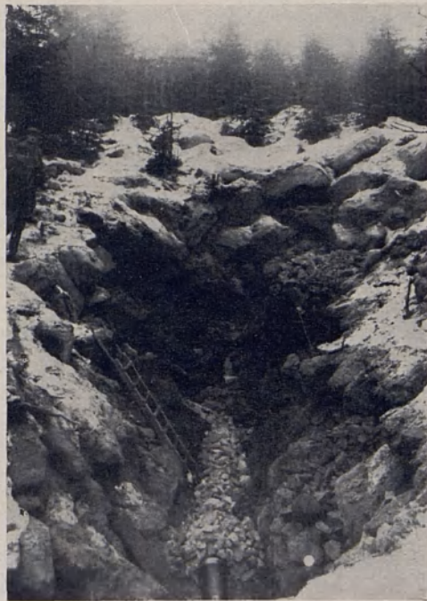
Quellenfassung für eine Wasserversorgung
