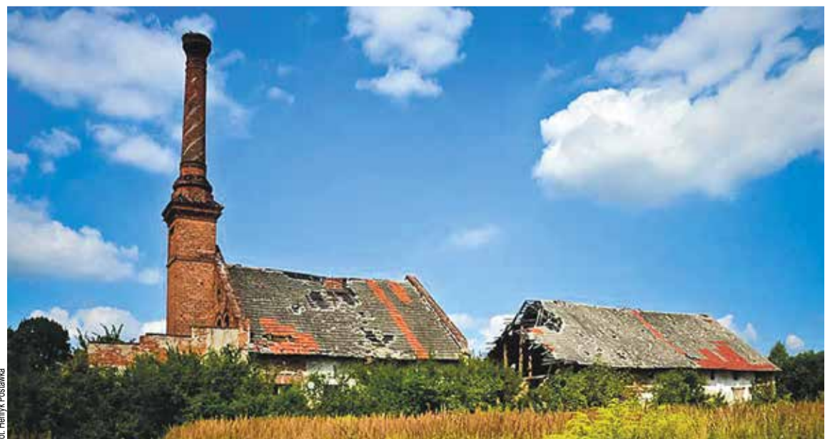
Gorzelnia i blachownia w Zawadzie. Stan obecny.
