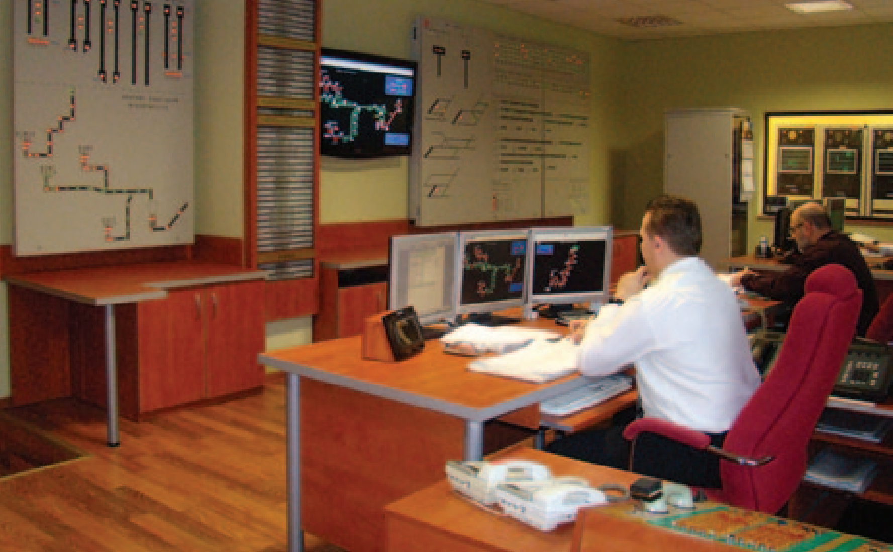
Dyspozytorzy pracują teraz w gruntownie wyremontowanym pomieszczeniu, w którym wymieniono instalacje elektryczne i oświetleniowe. Pomieszczenie jest klimatyzowane, a dyspozytorzy prowadzą ruch kopalni zza nowoczesnych, ergonomicznych pulpitów dyspozytorskich
