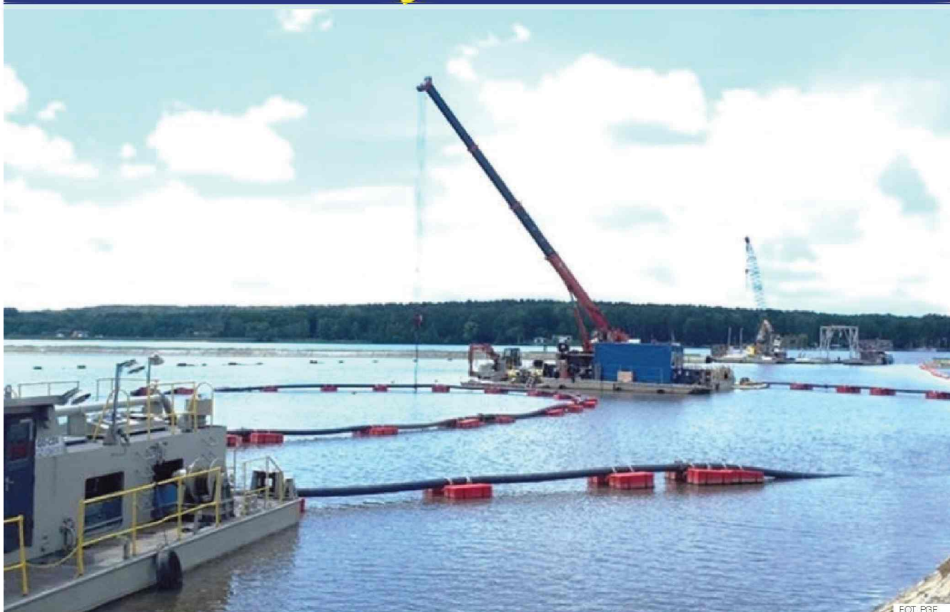
Na zdjęciu ujęcie wody chłodzącej
