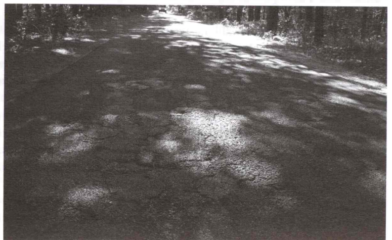
Nawierzchnia drogi pozostawia wiele do życzenia
