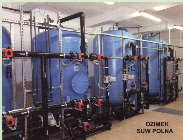
BIESTRZYNNIK - POMPOWIA ŚCIEKÓW SANITARNYCH P2
