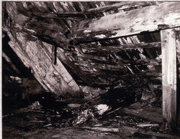
Całkowite zniszczenie konstrukcji dachu i pokrycie połaci południowej.
