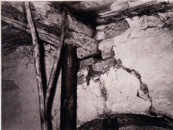
Pęknięcie, wyklinowane nadproże z opartą na nim belką stropową, zabezpieczenie prowizoryczne
