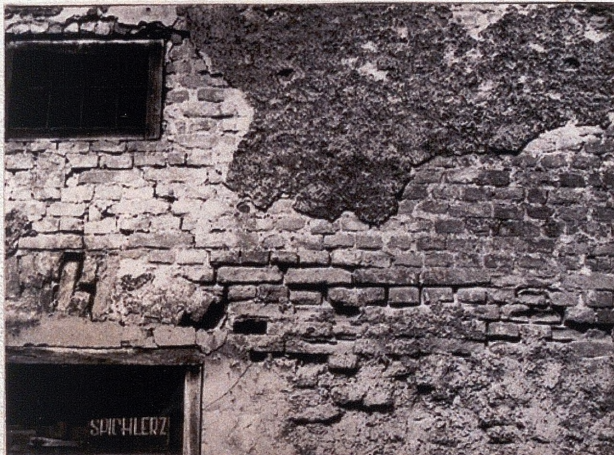
Mur południowy spękania w rejonie wejścia do budynku.
