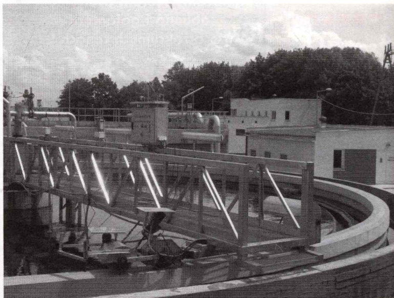
PGKiM w Ozimku dysponuje bardzo nowoczesną oczyszczalnią ścieków.
