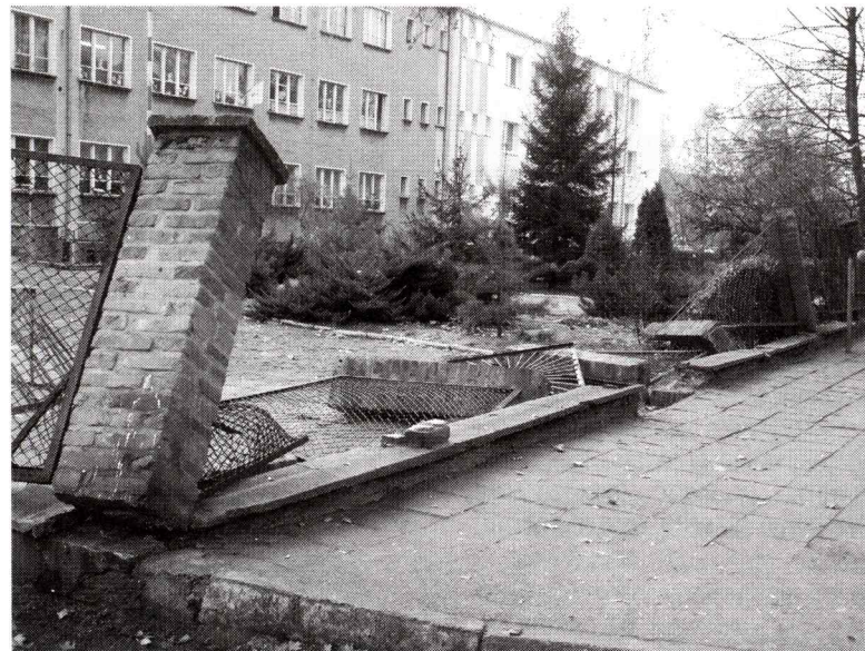
Zniszczone ogrodzenie wokół PSP nr 1.
