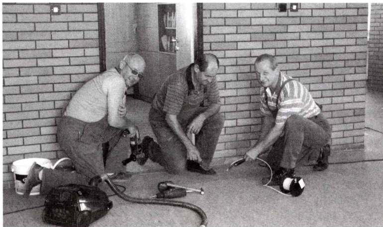
W SP nr 3 w Ozimku fachowcy wyremontowali posadzkę. Nowe wykładziny zakładali konserwatorzy z Gimnazjum nr 1: (od lewej) Jan Siedlaczek, Tadeusz Więdołcha i Jan Drapiewski.
